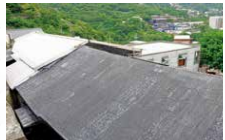
▲九份地區常年陰雨綿綿，所以這裡的屋頂常鋪設一層抹上黑色柏油的油毛氈，可以隔絕濕氣，而且建造費用便宜。這種屋子又叫黑紙厝或點仔膠厝，因為顏色是黑的，夏天時屋內會變得更加炎熱。
